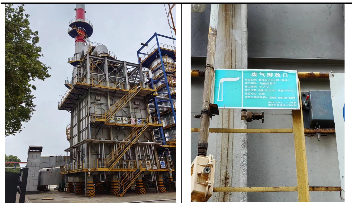
反应进料加热炉 DA031 排气筒及标识牌
