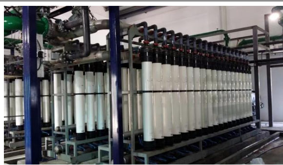
污水深度处理回用装置
