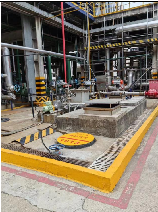
依托现有隔油池
