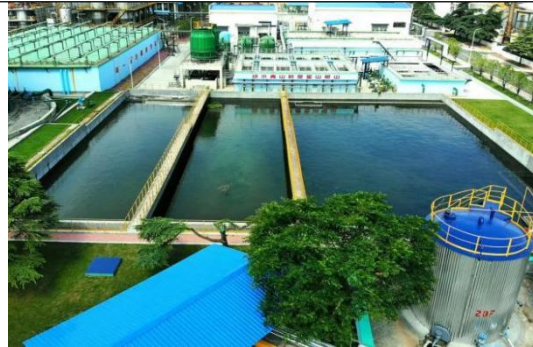
炼油厂区污水处理系统
