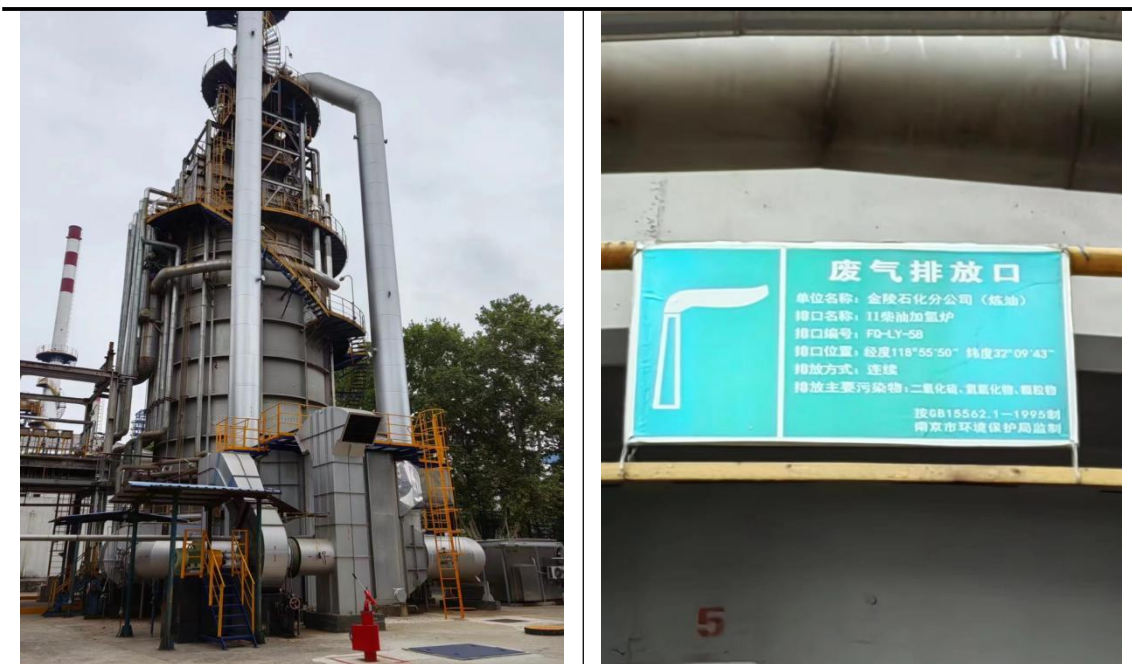
分馏塔底重沸炉 DA030 排气筒及标识牌
