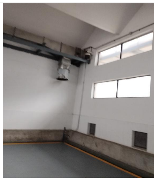
危废仓库内监控设备
